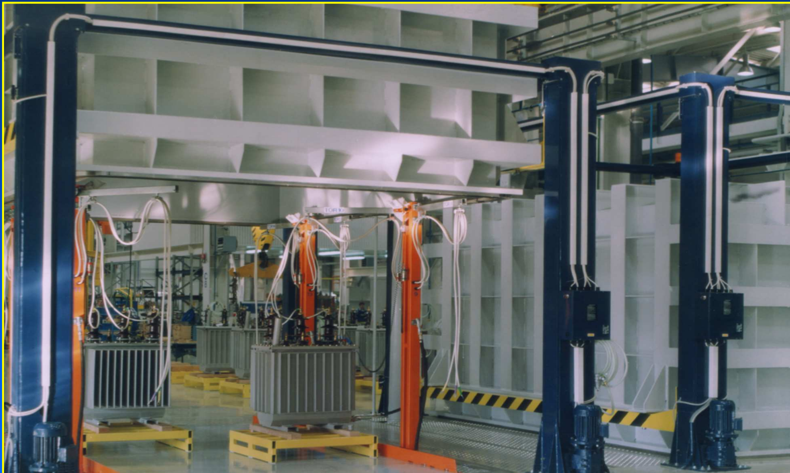
Zespół urządzeń do suszenia i impregnacji transformatorów rozdzielczych
